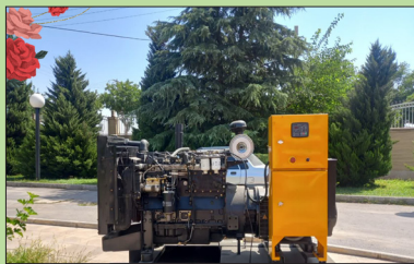
با توجه به ناترازی برق، تهیه و خرید یک دستگاه مولد برق جهت استفاده در شهرداری
